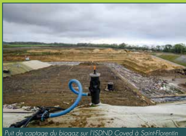
Puits de captage du biogaz sur l'ISDND Coved à Saint-Florentin
